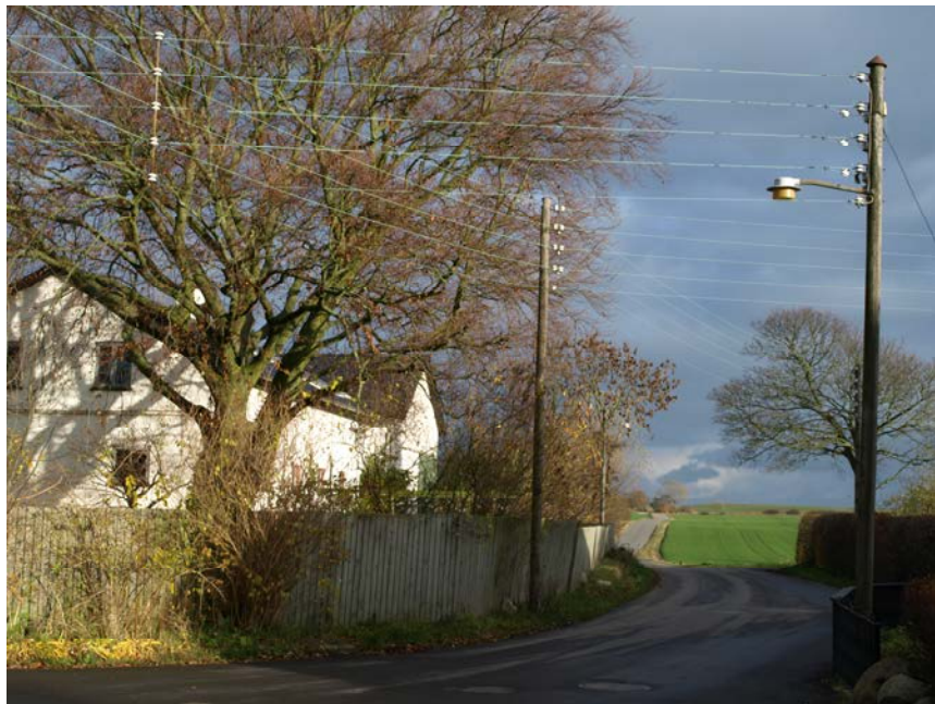
Belysningsanlæg på mast. Trafikvej, Kirke Såby
